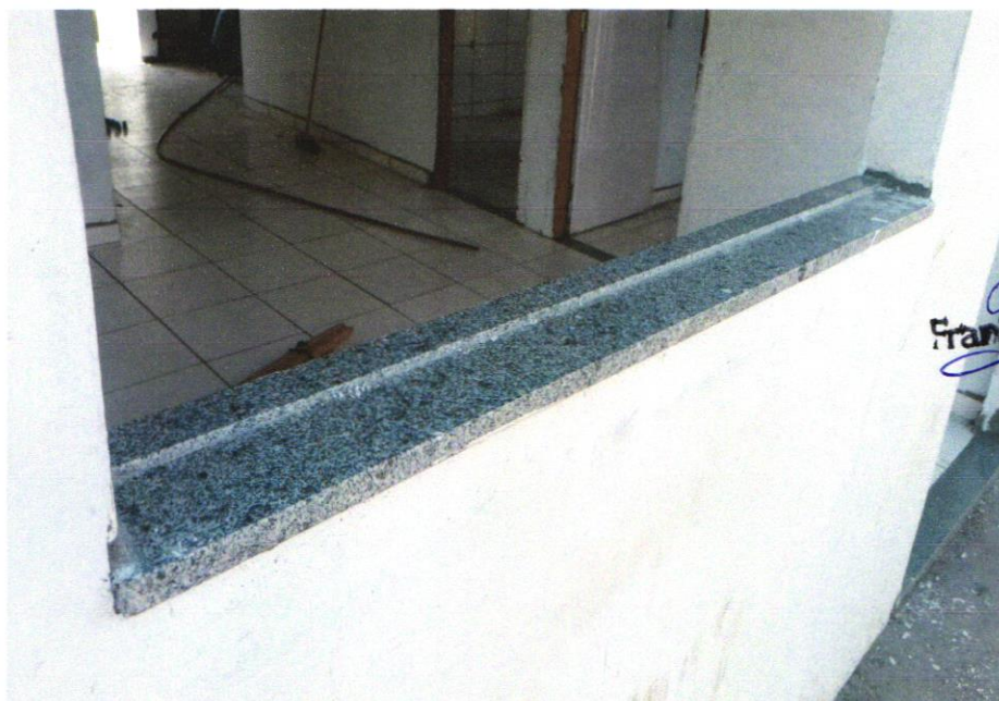
FOTO 25 - PEITORIL LINEAR EM GRANITO OU MÁRMORE, L = 15CM, COMPRIMENTO DE ATÉ 2M, ASSENTADO COM ARGAMASSA 1:6 COM ADITIVO. AF_11/2020
